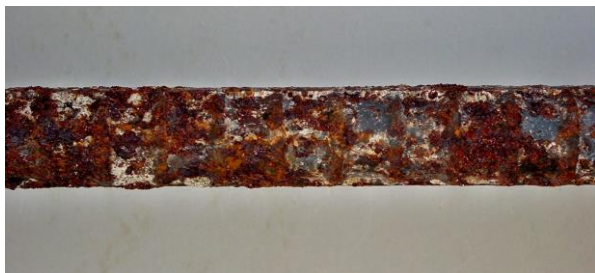
腐食度の段階 : III
