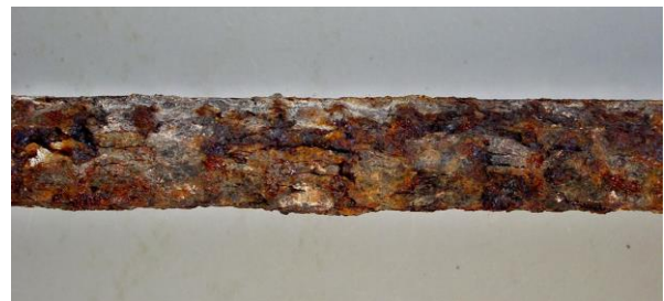
腐食度の段階 : IV
